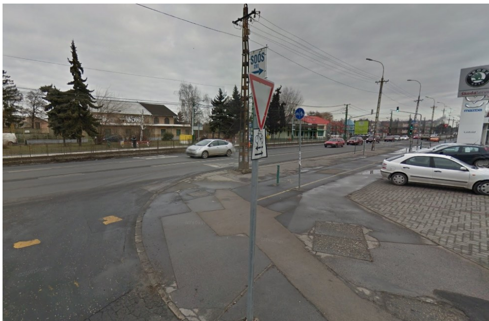
Lekopott felfestések, funkcióját veszített behajtásgátló oszlop
